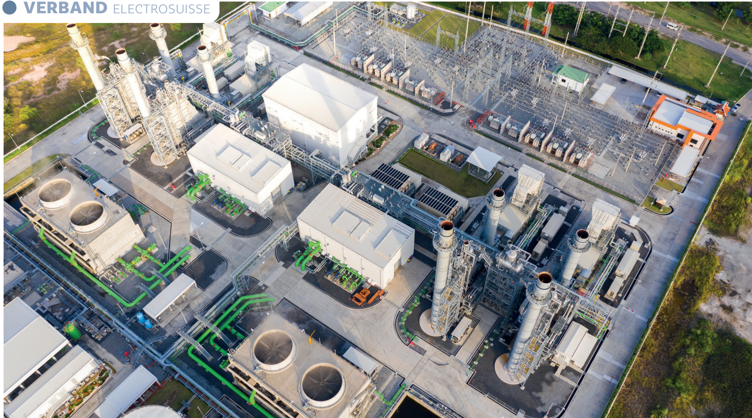
Ansicht von Umspannwerk, Elektrik und Produktion. ISTOCK
