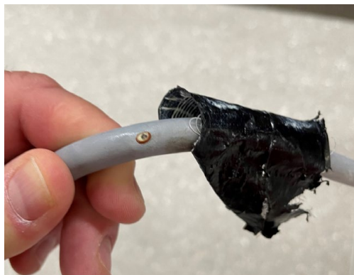
Figura 14: Isolamento difettoso del cavo (fonte ESTI)
