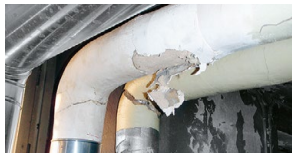
Malta nelle tubazioni
