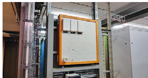
Apparecchiature assiemate di manovra
