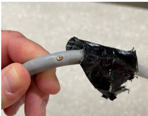
Figure 14: Isolation défectueuse d'un câble (source: ESTI)
