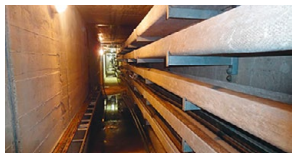
Chemins de câbles
