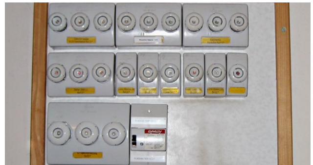
Elektroverteilung (Bild Suva)
