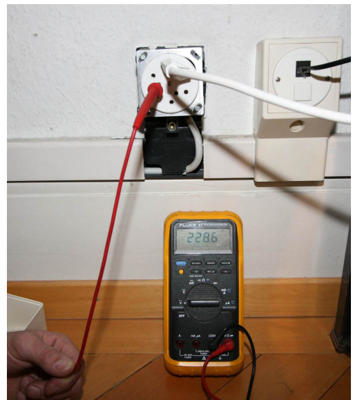
Bild 2: Unter Spannung stehende Steckdose
