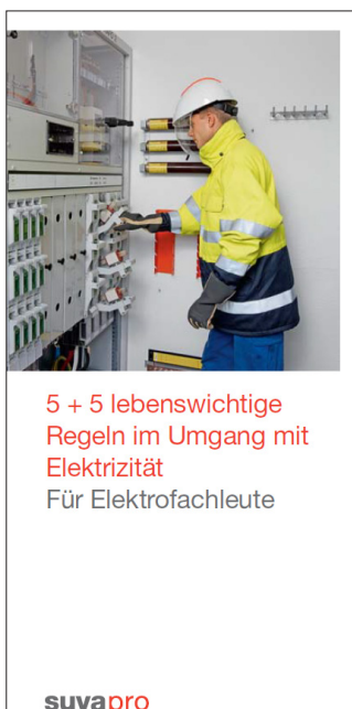
Faltprospekt zur Kampagne «Sichere Elektrizität» Bestellnummer: 84042.D
