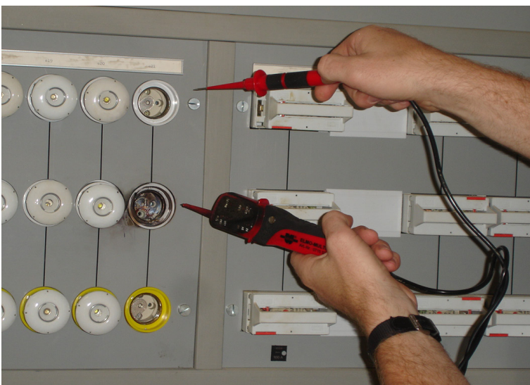
Bild 1: Messung in Unterverteilungsanlage
