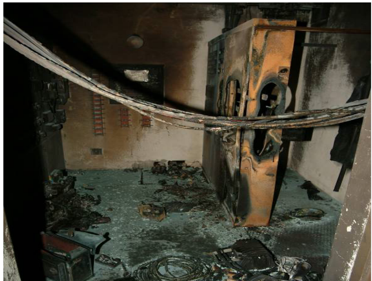
Bild 3: Schaltlichtbogen beim Betätigen der NHS-Sicherungen
